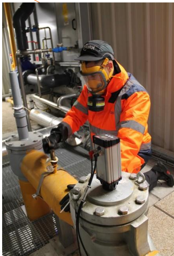
Technicien Matal en intervention sur circuit Ammoniac (NH 3 )
