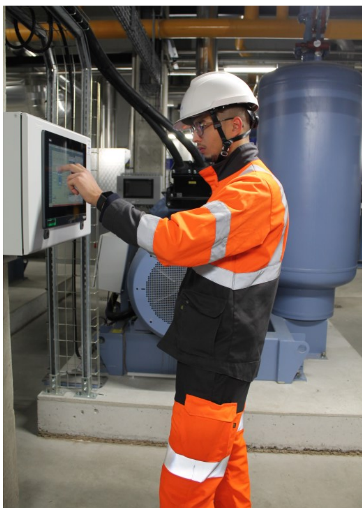
Technicien MATAL en intervention sur automate
