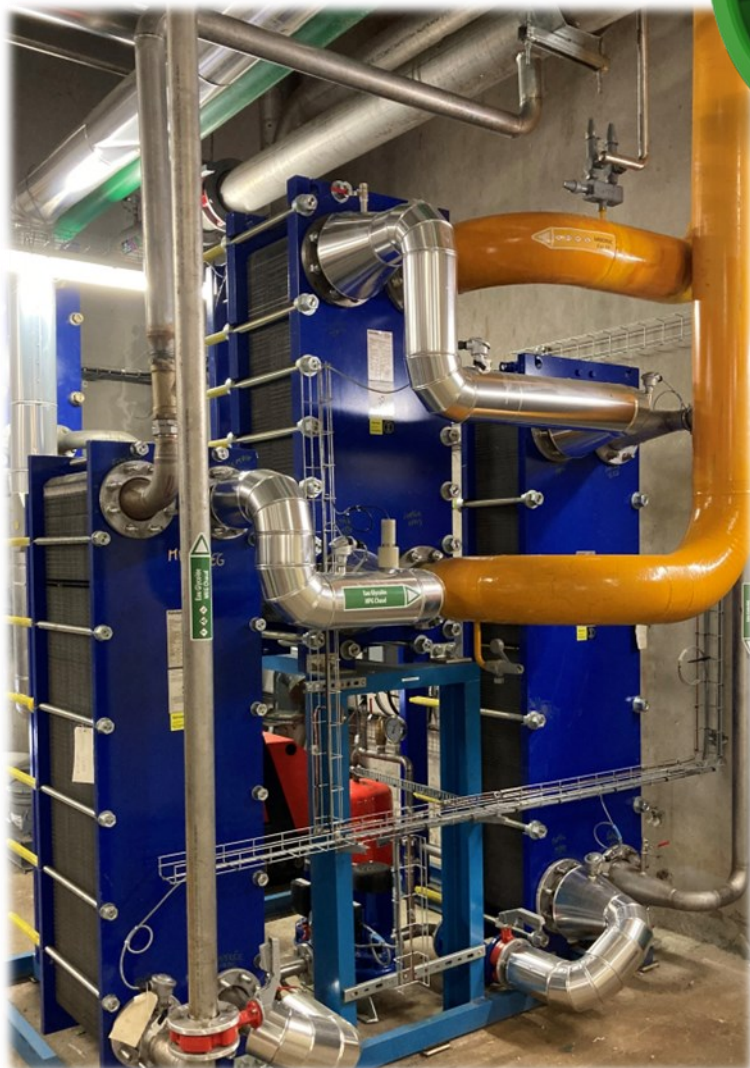
Skid récupération Energie Matal
